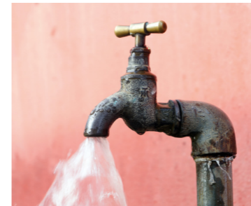
Doc. 6 Une canalisation d'eau.
